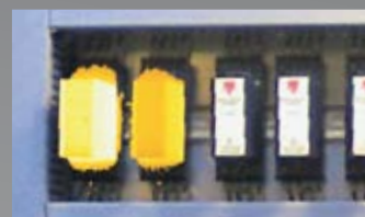
Immagine integrata FLIR Thermal Fusion di un interruttore di circuito surriscaldato.
