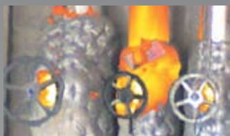
Immagine integrata FLIR Thermal Fusion di una perdita di vapore di una valvola
